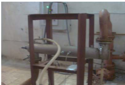
Рисунок 3. Установка для обеззараживания воды
