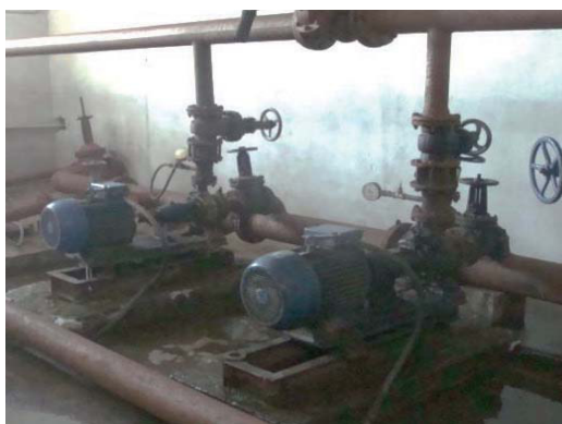
Рисунок 2. Установка для сливания воды из 4-х скважин
